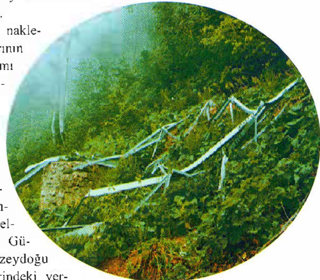
Şekil-8: Artvin-Erzurum arasındaki çığdan hasar gören enerji nakil hattı direği
