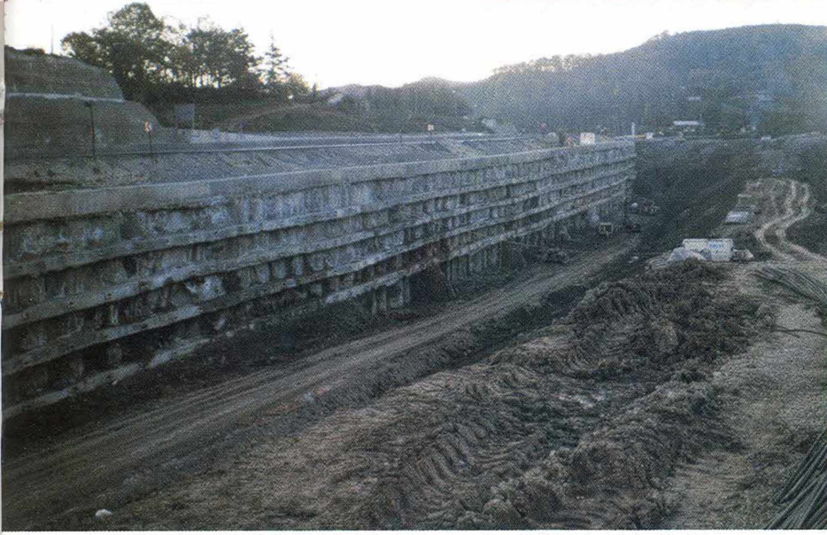
Şekil 14: E-5 Karayolunun Bolu Doğu'nda forekazık sistemiyle güçlendirilmiş kesiminden bir görünüm (Bu bölüm depremden etkilenmemiştir).
